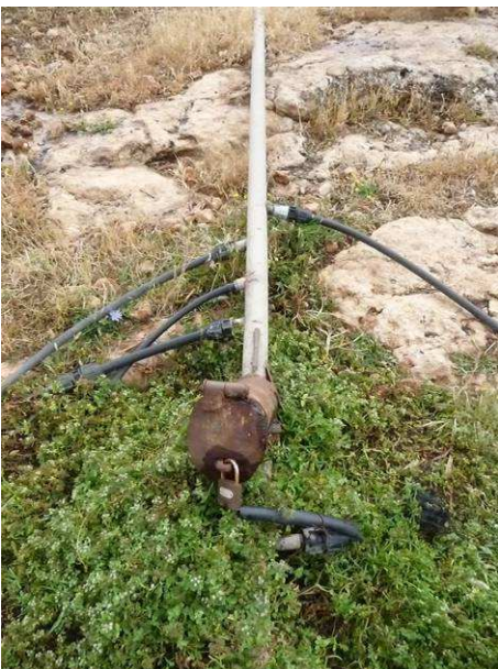
Réseau de distribution
